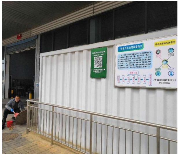
污水处理设施
